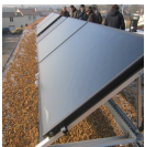
Eau chaude sanitaire solaire
